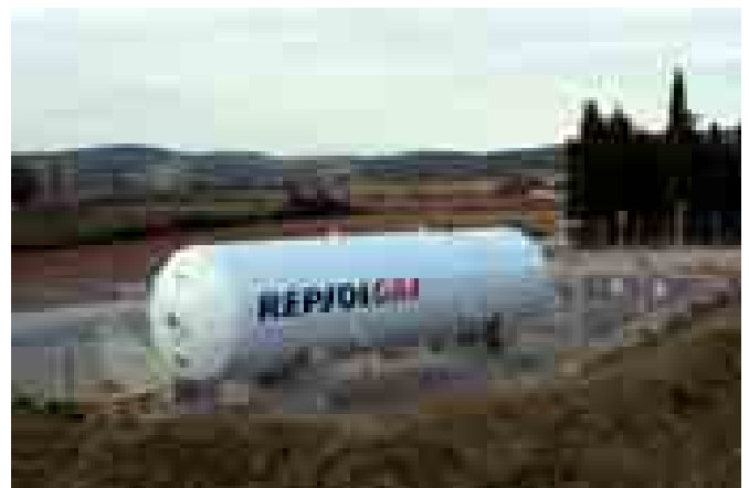
Centre d'emmagatzematge de gas situat prop del cementiri municipal.
